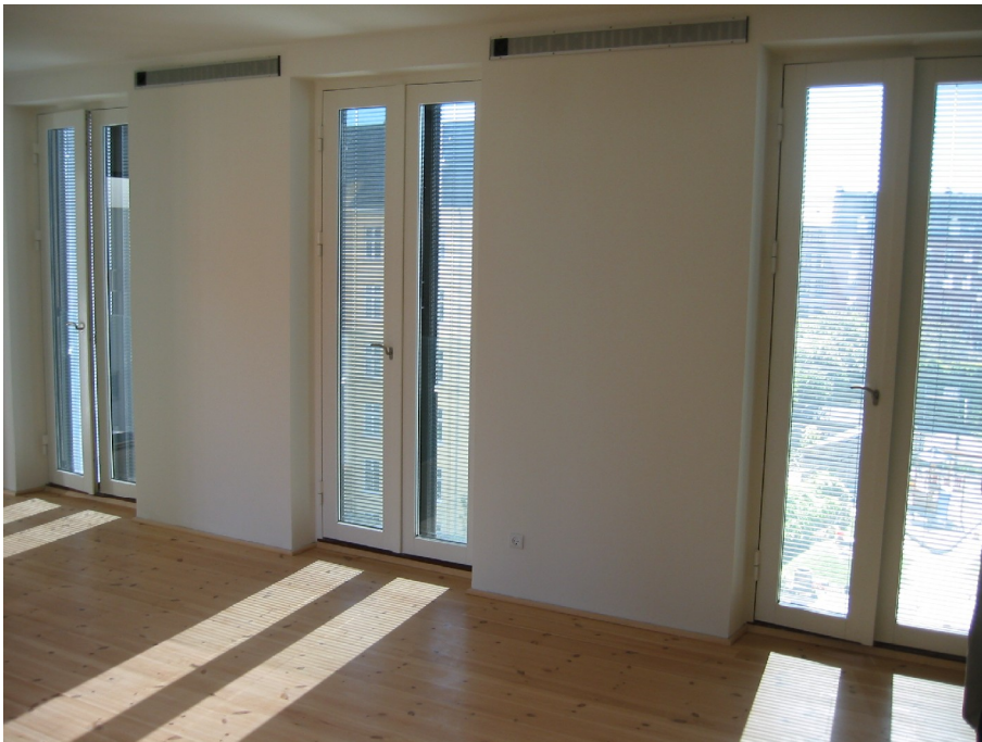
I muren mellem de franske døre ses friskluftventilerne.
